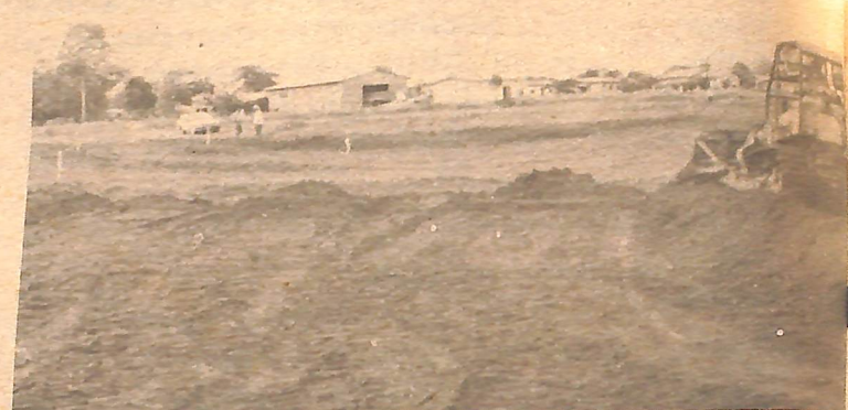
Início das obras na avenida Pará, margeando a reserva do Córrego Lucas do Rio Verde.
